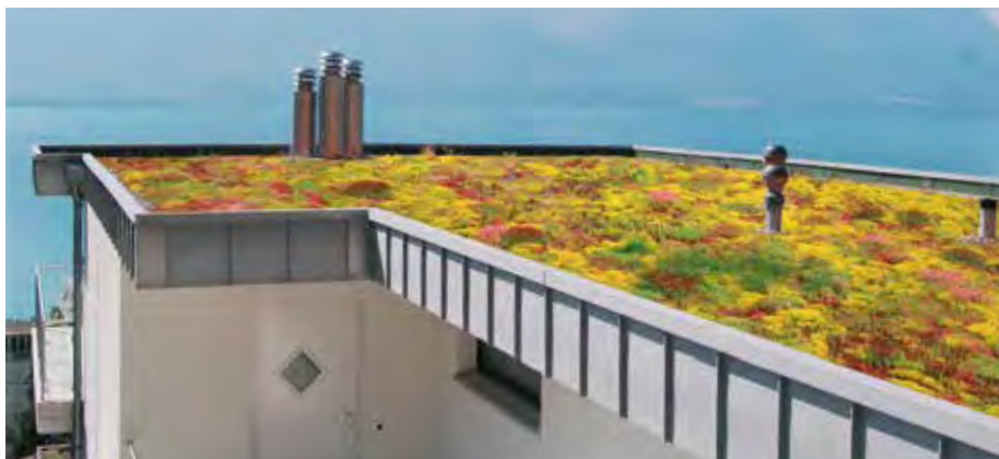
Cubiertas verdes extensivas
