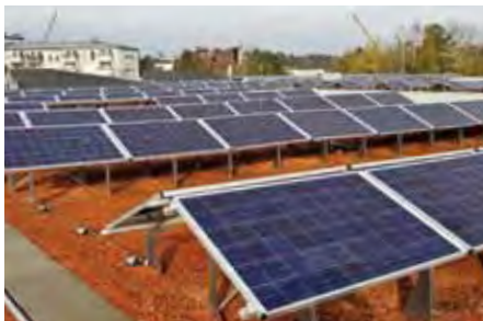
Sistema de montaje con orientación Este-Oeste, instalación de forma "a dos aguas".
