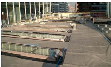
Toda la superficie esta cubierta por el elemento de drenaje Floradrain®. Las tuberías de riego están instaladas por encima del filtro.
